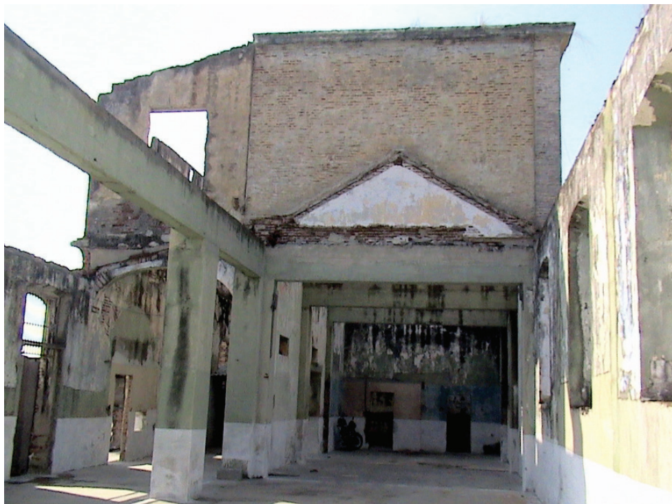
Figura 5. Destrucción total de la obra de madera. Fuente: Autor, 2007.
