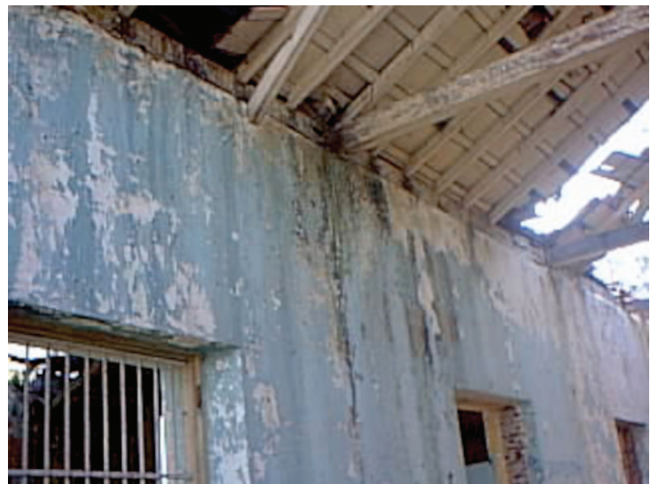
Figura 4. Estado técnico de la cubierta de la planta alta. Fuente: Misael Cabrera, 1999.
