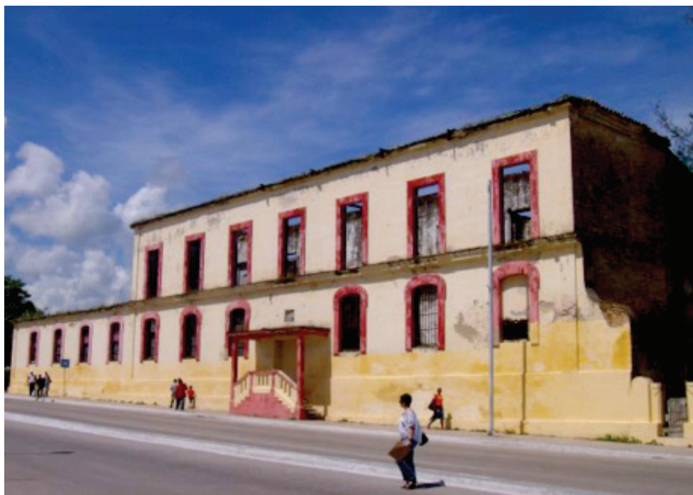
Figura 6. Edificio en ruinas sin su cubierta. Se aprecia la fachada principal alterada por una portada inarmónica. Fuente: Autor, 2007
