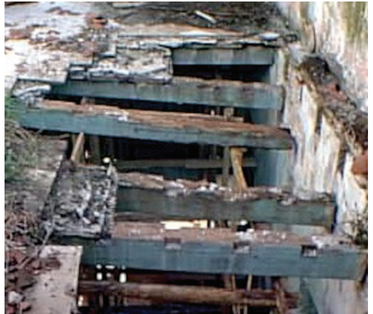
Figura 3. Estado técnico del forjado. Fuente: Misael Cabrera, 1999.
