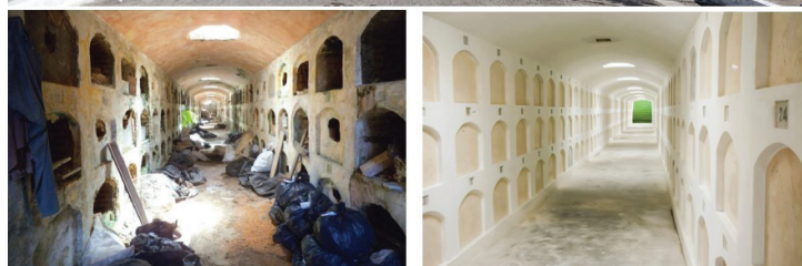
Figura 10. Acciones de conservación en el Cementerio San Carlos Borromeo, Matanzas. Fuente: Autores.
