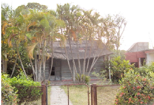
La falta de mantenimiento está destruyendo símbolos históricos en los bateyes. Vivienda original en crítico estado de deterioro, del central Manuel Martínez Prieto, en Marianao.
