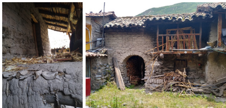
Figura 4. Pisos y cubiertas: A la izquierda, entrepiso de torta de barro y enchaclado de carrizo amarradas con soguillas de paja. A la derecha, cubierta de teja de arcilla cocida que descansa sobre tijeral de par y nudillo de rollizo de eucalipto. Fuente: Autor.
