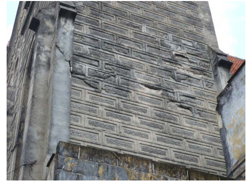
Figura 16. Deterioros que se aprecian en el lateral del bloque izquierdo de la fachada principal. Fuente: autor.
