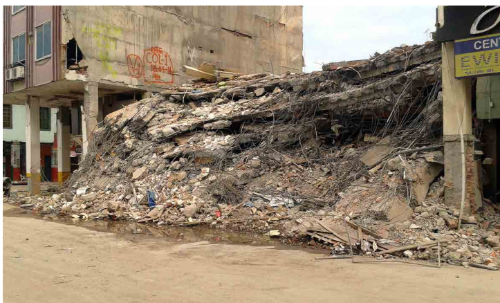
Figura 6. Hotel "El Gato" de Portoviejo totalmente colapsado. (Foto Hidalgo 2016).
