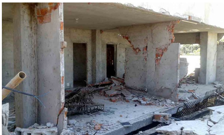
Figura 4. Vivienda particular parcialmente destruida en Portoviejo. (Foto Hidalgo 2016).
