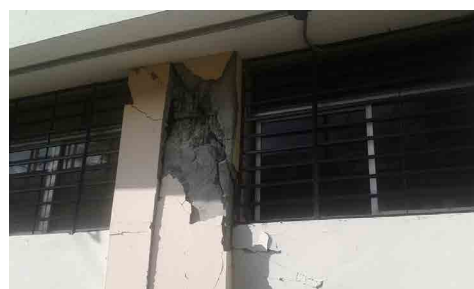
Figura 1 Edificio de la Facultad de Ciencias Matemáticas, Física y Química de la Universidad Técnica de Manabí actualmente demolido. (Foto Hidalgo, 2016).
