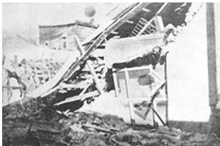
Figura 7. Daños provocados por el terremoto del 3 de febrero de 1932 en Santiago de Cuba en almacenes de víveres de la Alameda. (Fuente: Fotos cortesía del Dr. Chuy).
