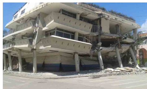
Figura 2. Edificio de Vivienda en el centro de Portoviejo totalmente afectado. (Foto Hidalgo, 2016).
