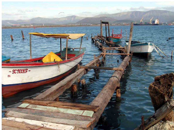
Figura 11. Muelle de los pescadores afectado por el oleaje. (Foto Milanés, 2012).
