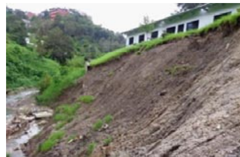
Figura 5. Desplome del muro de contención y deslave del talud. Fuente. Periódico El Sol de Puebla .
