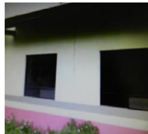
Figura 8. Fractura en muro lateral de la guardería. Fuente. Periódico El Sol de Puebla .
