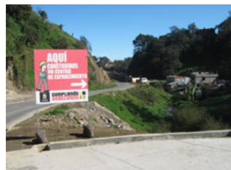
Figura 3. Lugar donde discurre una de las ramas de desalojo acuífero y de drenaje. Fuente. Autores
