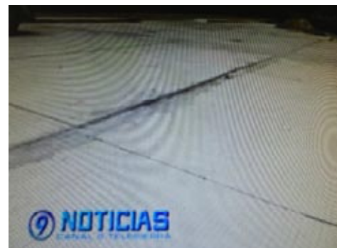
Figura 6. Hundimiento y fractura de losa del estacionamiento. Periódico El Sol de Puebla .
