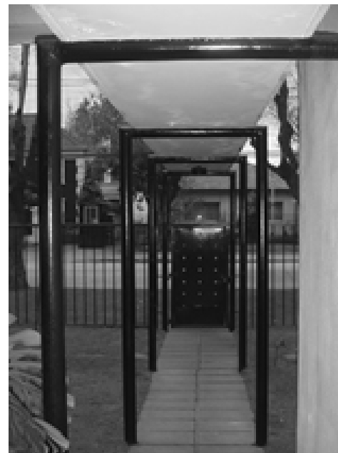
Figura 13: Canopy de acceso y puerta de reja con revestimiento perforado. Fuente: archivo fotográfico del autor.
