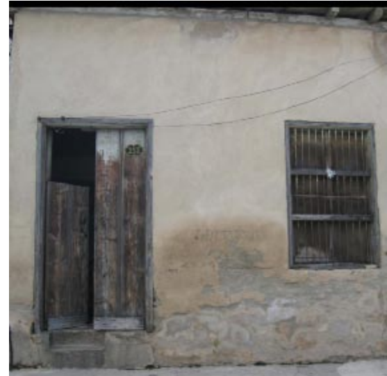
Figuras 1, 2 y 3. Efectos de la humedad capilar y el deterioro en viviendas coloniales. Fuente: autores.
