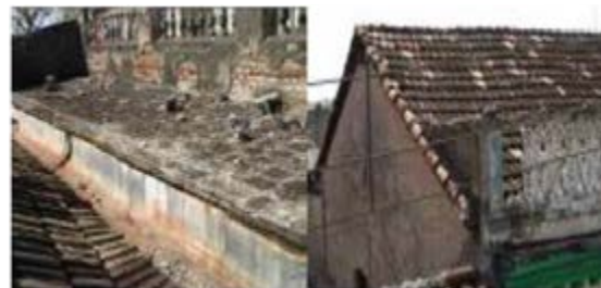
Figura 11: Soluciones constructivas con la presencia del pretil Género lesiones que afectan a los elementos de la cubierta y de la fachada. Fuente: Coralina Vas Suárez.
