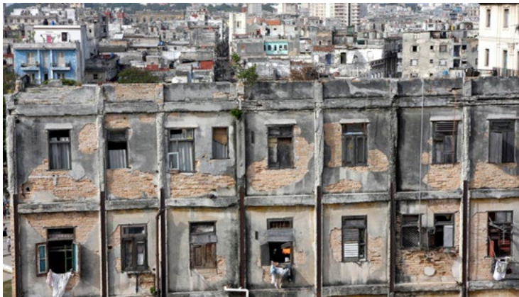
Figura 1. Edificio deteriorado, y habitado, detrás del Capitolio.
