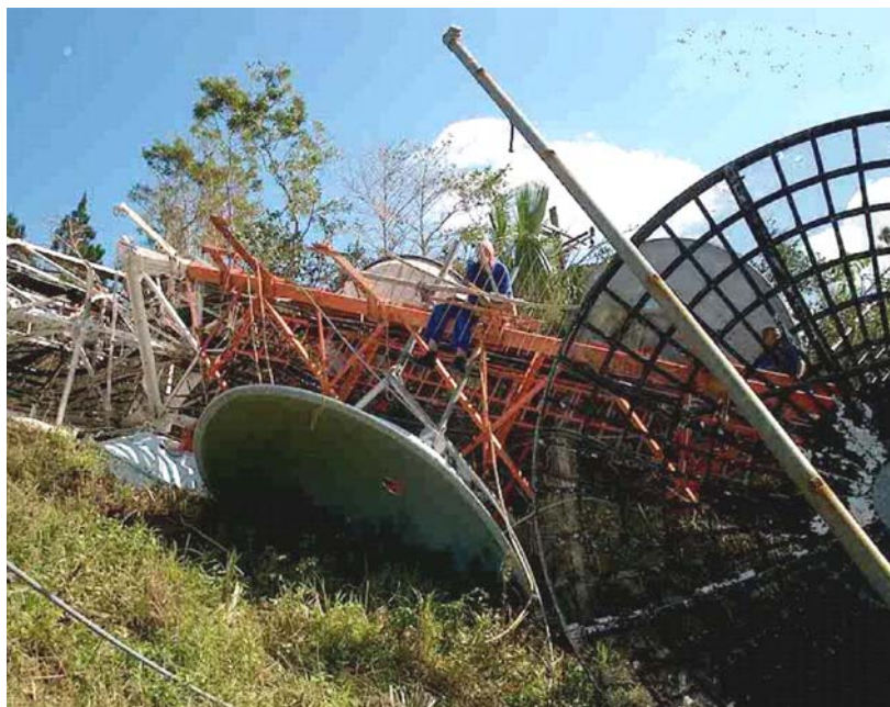
Presencia de antenas sobre torre colapsada.
