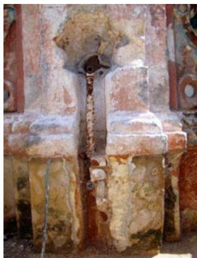
Figura 10. Tubería de hierro insertada en pilón de la fuente.
